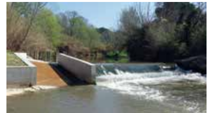
Le nouveau seuil de Gordes, équipé d'une rampe à anguilles.
